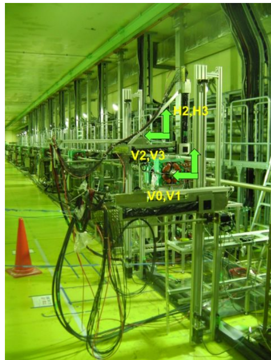
図3：ACS部に設置した検出器と遠隔位置制御装置
