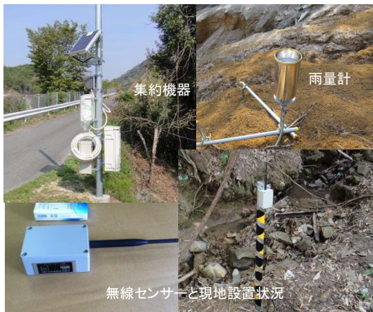
図-5 設置機器の概況
