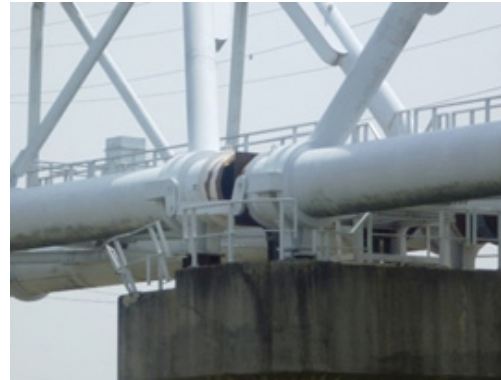
図1 那珂川水管橋の被害状況
