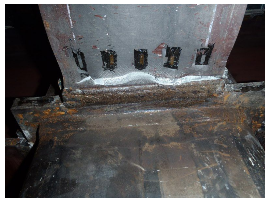
写真2 端の下フランジ破断(1体目)
