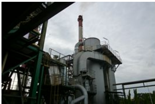
写真1 廃棄物処理プラントの集塵装置
