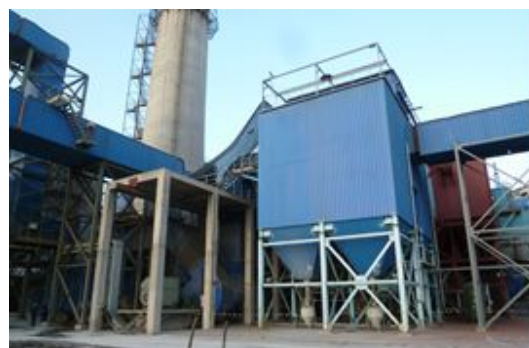
写真3 中国の固定発生源の集じん機
