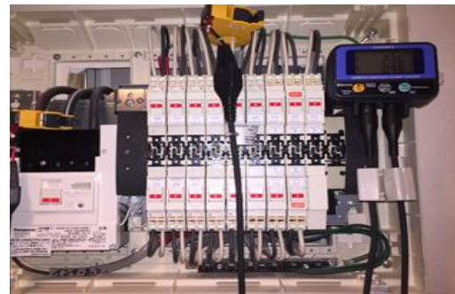
図 9 分電盤内の消費電流波形の測定
