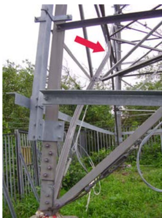
図1. 地盤変状による鉄塔損傷例
