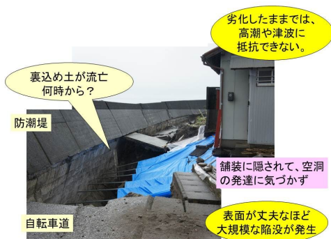
図1 護岸の空洞化
