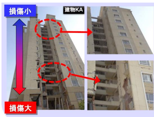
図 7 ネパール地震での高層集合住宅の被害
