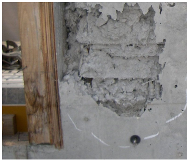
写真1 窓枠付近での空洞の例
