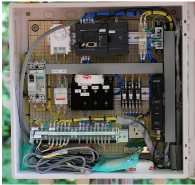
採水ポンプ・電磁弁などの制御板
