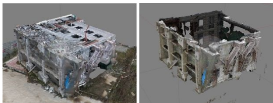
図3 空撮画像のみから構築した3Dモデル(左)と地上撮影画像のみから構築した3Dモデル(右)
