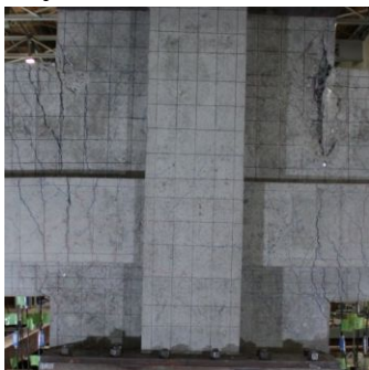
図5 損傷状況 (No.1)
