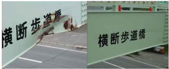
b) 損傷・補修状況
