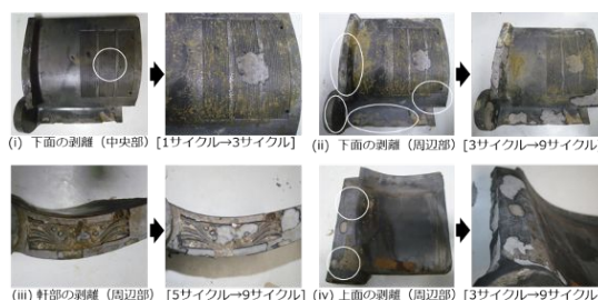
図12 凍結融解実験による瓦の劣化の進行
