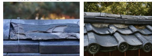
図7 特徴的な瓦の劣化
