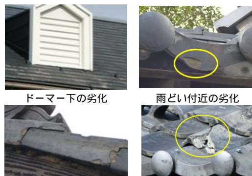
図11 広域調査で観察された劣化
