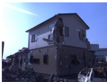
写真1 2階のみに大規模損壊
